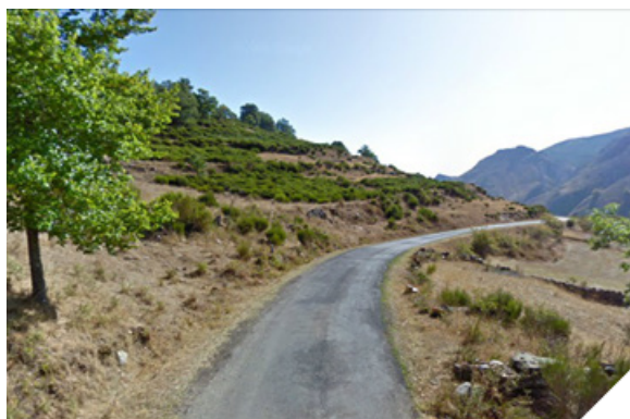
Ilustración 38 Margen peligroso (desmonte, terraplén, cuentas, bordillos, obstáculos puntuales, etc.).
