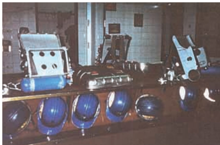
Sala de control, dotada con: equipos para cargar baterías; buscapersonas; lavadero de aparatos; lavadora desinfectadora; secadores de aire caliente; autorrescatadores, y extintores.
